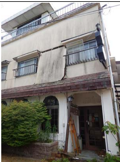
11 2階の壁（パネル）が外れています。
