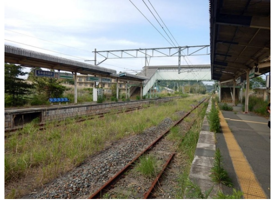
14 ホームと線路には草がはびこっています。
